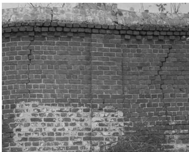
Рис. 1. Разрушение стен, огораживающих территорию Иоанно-Предтеченского монастыря
